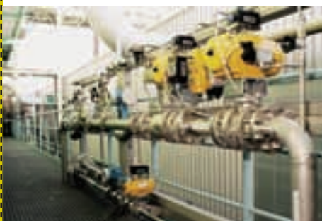
Ventilskid för reglering av syreflödet
